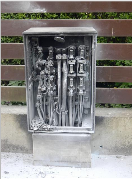
Brand eines E-Verteilers 28.04.2015
